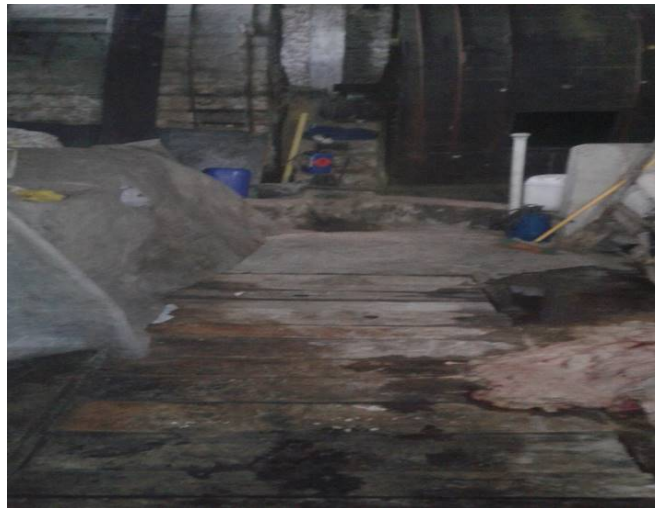
Foto No. 5 Sistema de tratamiento de ARND.
